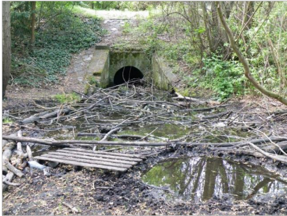
Abbildung 28: Einlaufbauwerk im Regenrückhaltebecken (Eigene Fotografie vom 01.05.2019)
