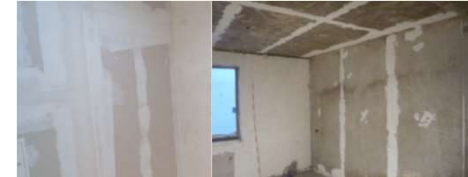
Asbesth. Spachtelmassen + Putze
