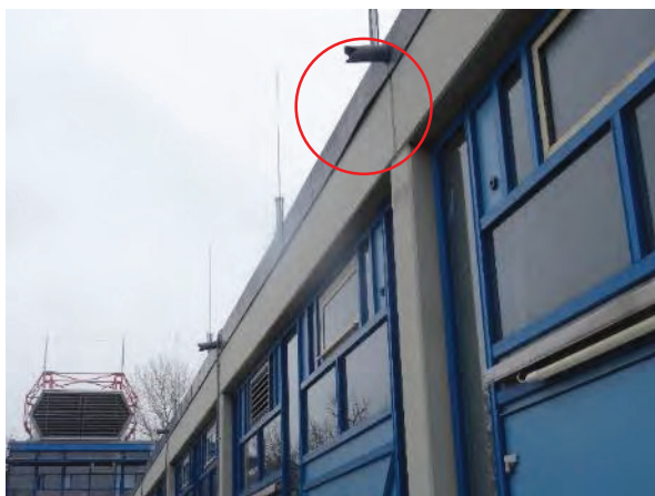
Abbildung 53: abstehendes Attikablech (rot umkreist) an Nordseite
