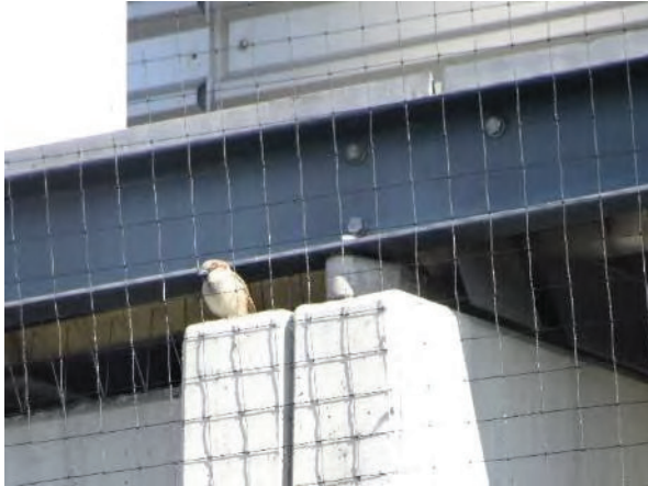
Abbildung 22: Haussperling auf Betonpfeiler, tschilpend vor seinem Nistplatz
